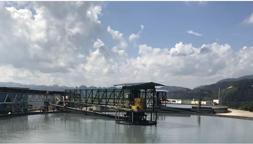
华联锌铟新田车间废水处理设施
