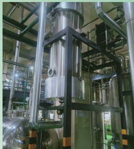
连接浓缩设备使用的冷凝器
