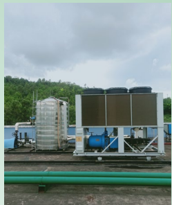
安装在室外的冷冻机组
