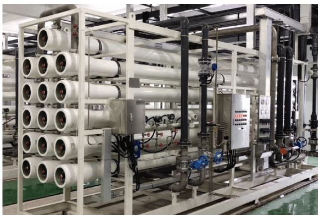
云南首家：云天化水富基地废水资源化利用减排项目 全线贯通，实现废水“零排放”
