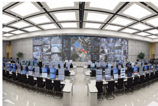
天安化工“四区分离”主控室建成使用
