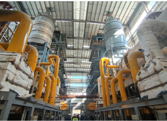
医废焚烧处置设备
