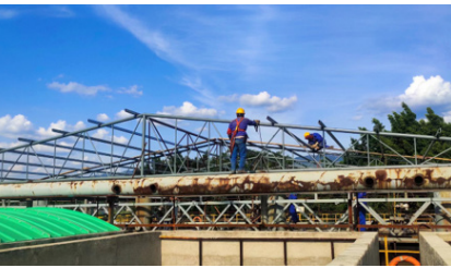
解化分公司 VOCs 治理
