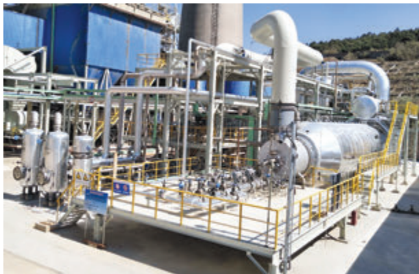
先锋化工新增尾气燃烧炉
