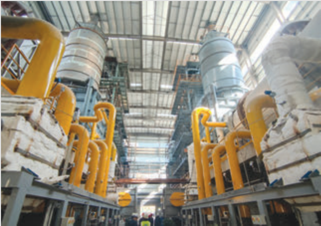
医废焚烧处置设备
