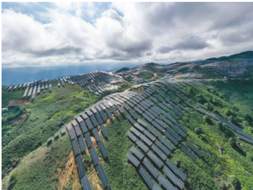
光伏新能源项目
