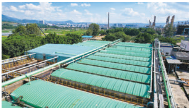
解化分公司 VOCs 治理（生化池抽吸系统）
