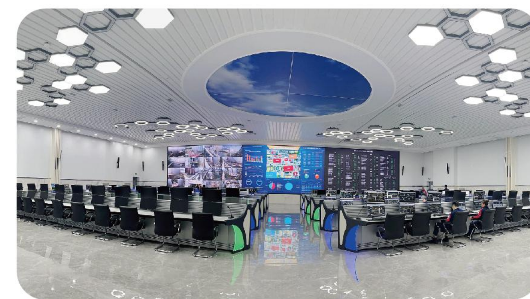
● 水富云天化中心控制室
