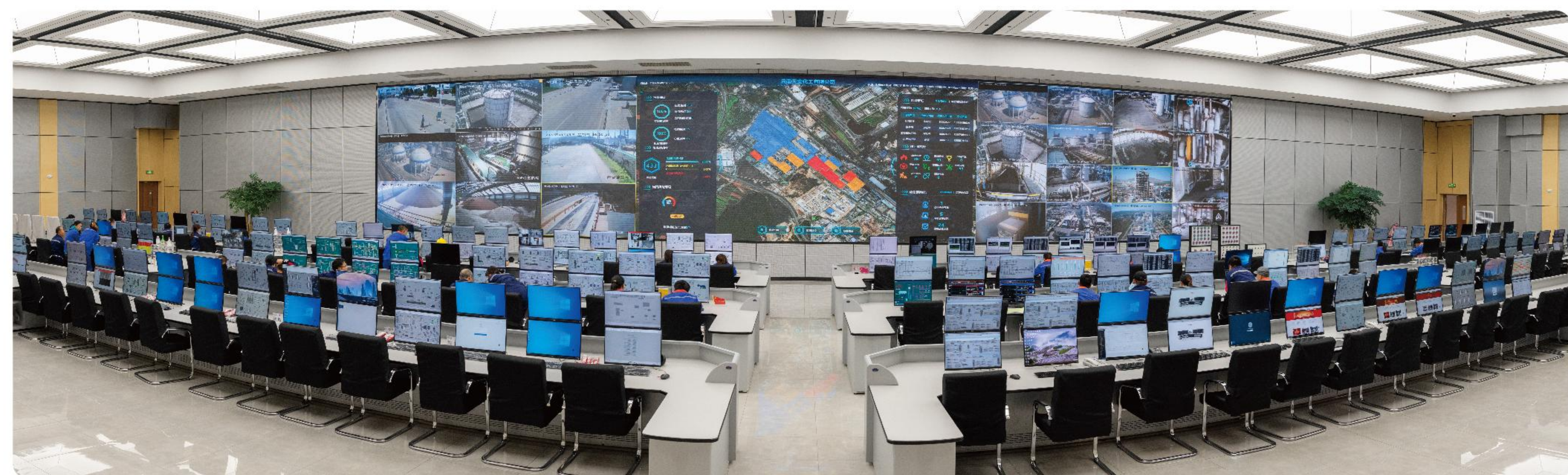
云天化天安化工中央控制室
